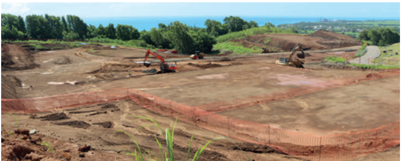
Ce nouveau centre de 18 000 m 2 traitera chaque année 170 000 tonnes de déchets ménagers et d'entreprises.
